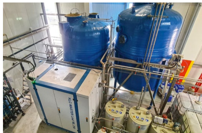
Die Vorbehandlungsanlage ist jetzt mit einer Abwassertechnik für die Aufbereitung der Prozessabwässer ausgestattet.
